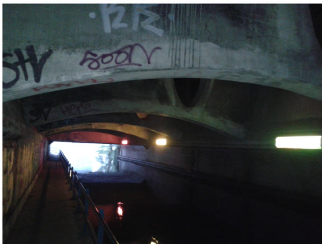
13 Foto's Plofduiker onder de Waterlinieweg
