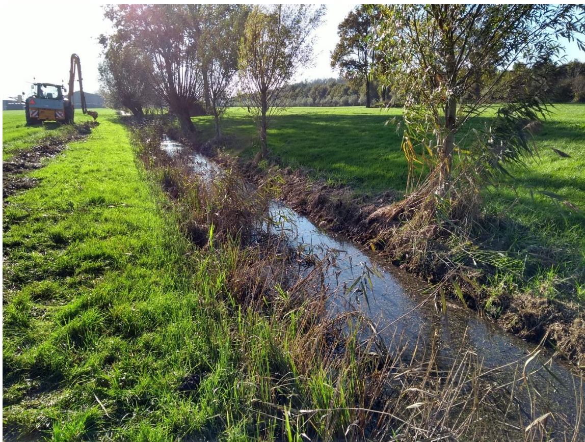
Door tijdens slootshoning boven de modderbodem te maaien en de zijde waar naartoe gewerkt wordt (linkeroever op de foto) te sparen, hebben vissen veel meer vluchtmogelijkheden (foto genomen bij demo ecologisch slootshonen in Overlangbroek).
