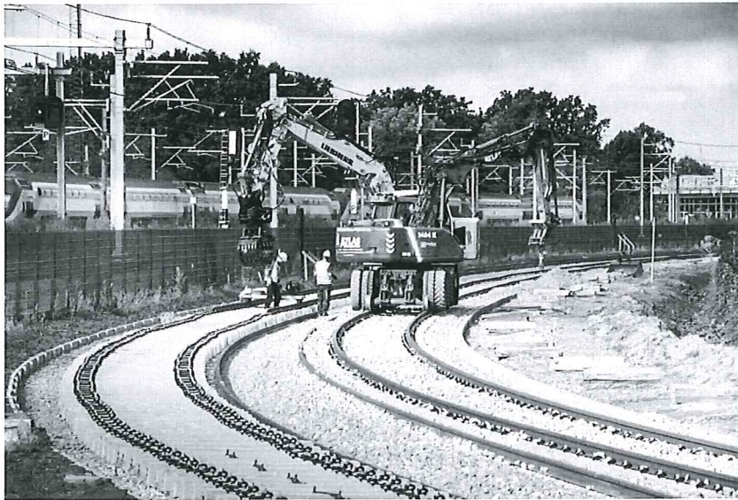
Werkzaamheden naast de spoorlijn Utrecht-Arnhem, ter hoogte van de Laan van Maarschalkerweerd
