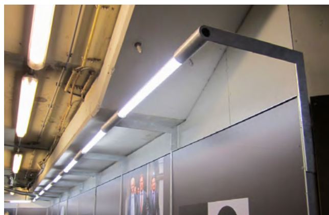
2. Toepassing van TL-verlichting met kabelgoot, Amsterdam Centraal Station.
