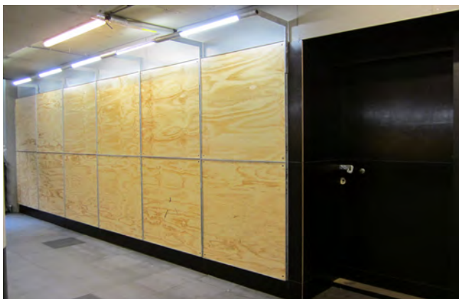
4. Toepassing van TL-verlichting met kabelgoot, Utrecht Centraal Station.
