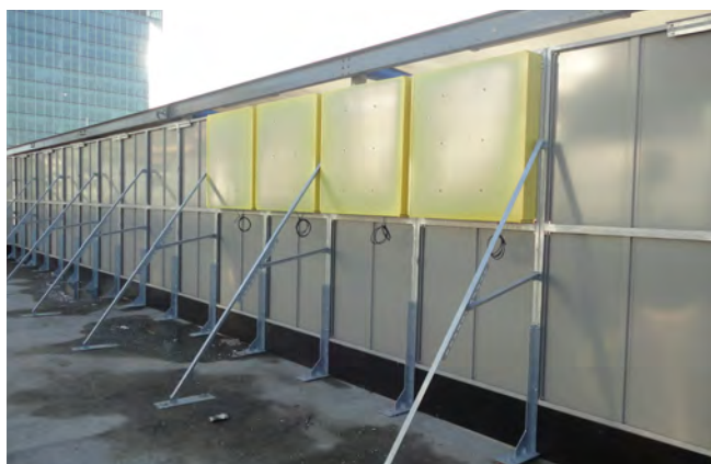
1. Toepassing van lichtbakken op vrijstaande wandframes, gezien van de achterkant, Utrecht Centraal Station.
